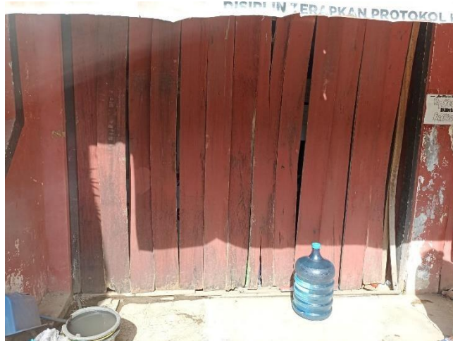
Gambar 2. 5 Kondisi kerusakan toko kelontong setelah banjir
